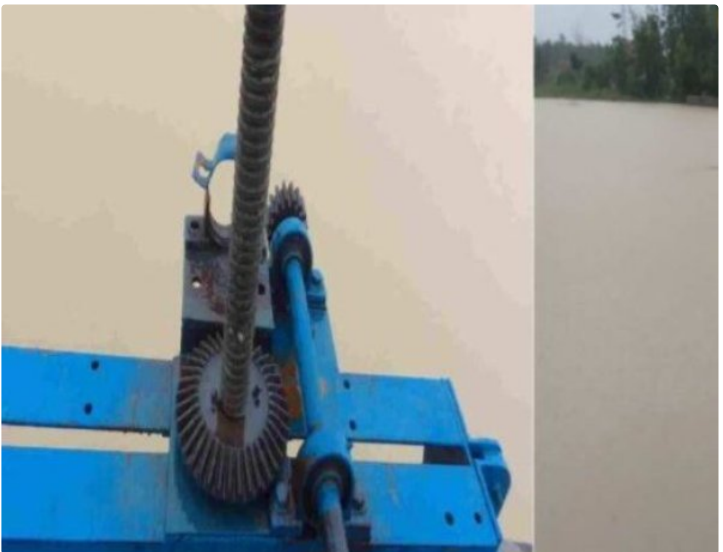
Pintu air Albaret Simpang Mesuji
